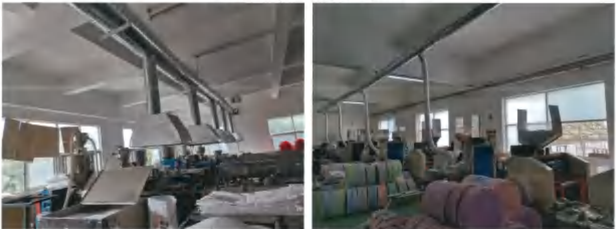
图 10-2 废气现场收集情况照片
