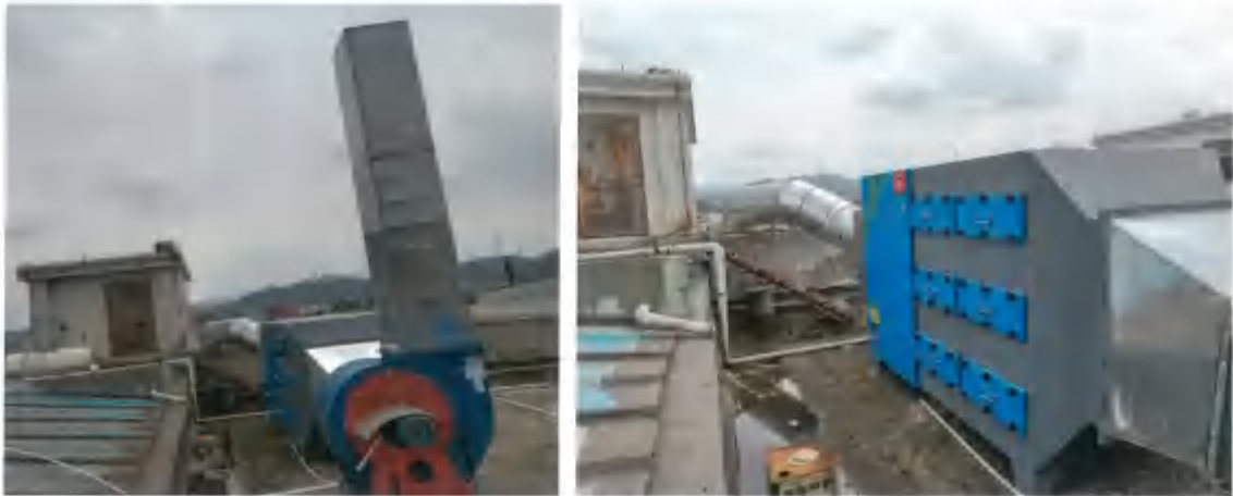
图 10-1 废气处理设施照片
